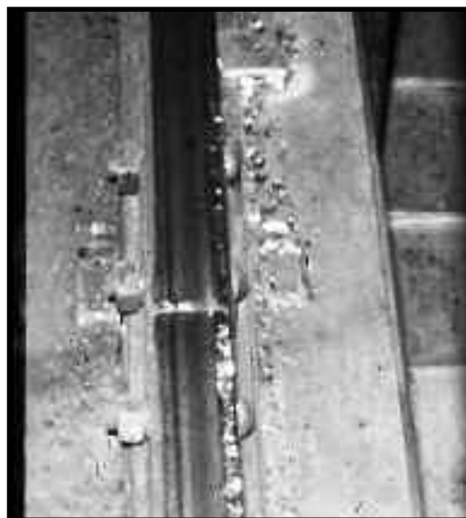
Poškození spoje kolejnic
