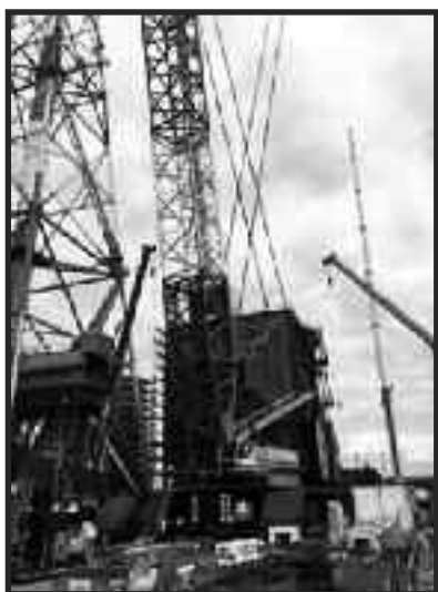
Uchimiya Transportation a jejich Terex CC 6800 instalující část kotle v elektrárně Setouchi v Japonsku.
